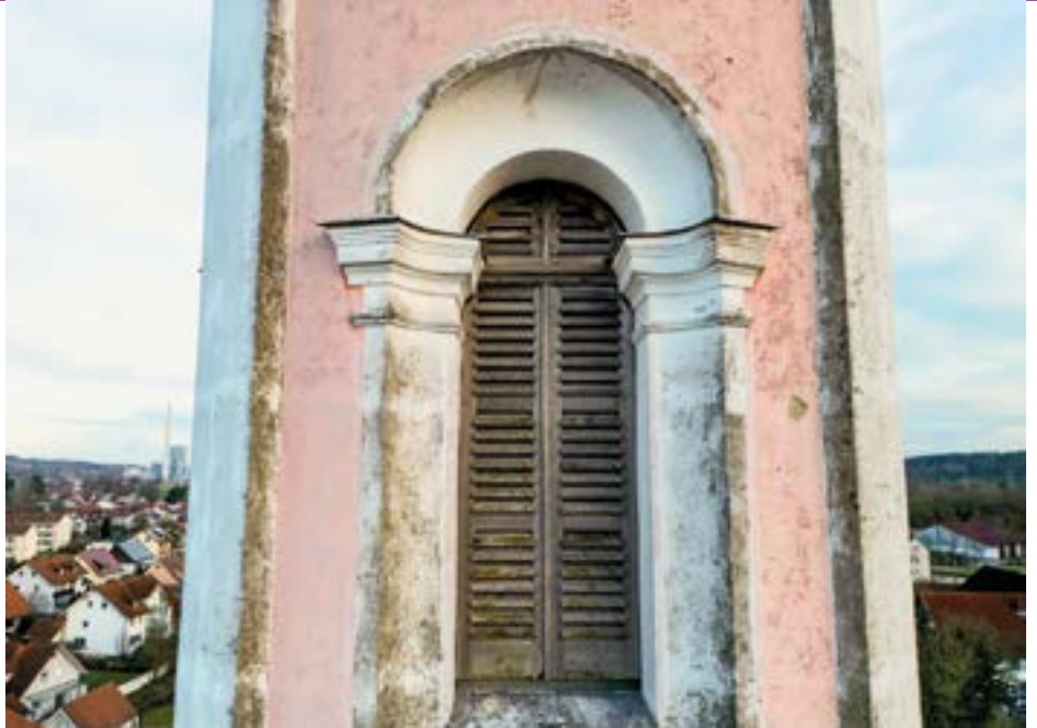
Ein Drohnenflug macht sichtbar, was von unten mit dem bloßen Auge nur schwer erkennbar ist: Die Fassade des außergewöhnlichen Zollinger Kirchturms hat Schäden und auch ein Anstrich steht im Zuge der großen Sanierung an.
