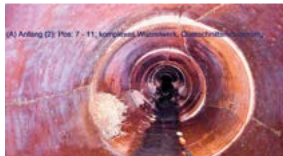
Bei Kamerabefahrungen werden Risse und Einwüchse (links) in ein Abwasserrohr sichtbar. Solche Schäden gibt es auch im Zollinger Netz. Sie müssen jetzt behoben werden.
